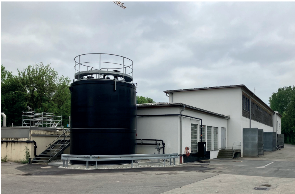
Abbildung 4: Ansicht der in 2022/2023 umgesetzten Erneuerung der Fällmittelanlage mit neuem Tank und Dosierstation
